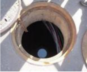
(d) 电力电缆井
