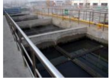
(f) 污水处理池
